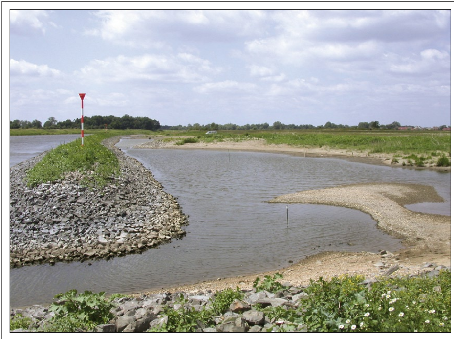
Abb. 7-34: Parallelwerk bei Gallin (stromauf von Lutherstadt Wittenberg am Elbe-km 204 rechtes Ufer, Juni 2003) in Blickrichtung stromabwärts. Im Vordergrund ist die Einstromöffnung aus dem Hauptstrom (links) zu sehen. Die Verengung der Wasserfläche im Mittelgrund ist durch die Überreste einer zerstörten Buhne verursacht. (Foto: X.-F. GARCIA)
